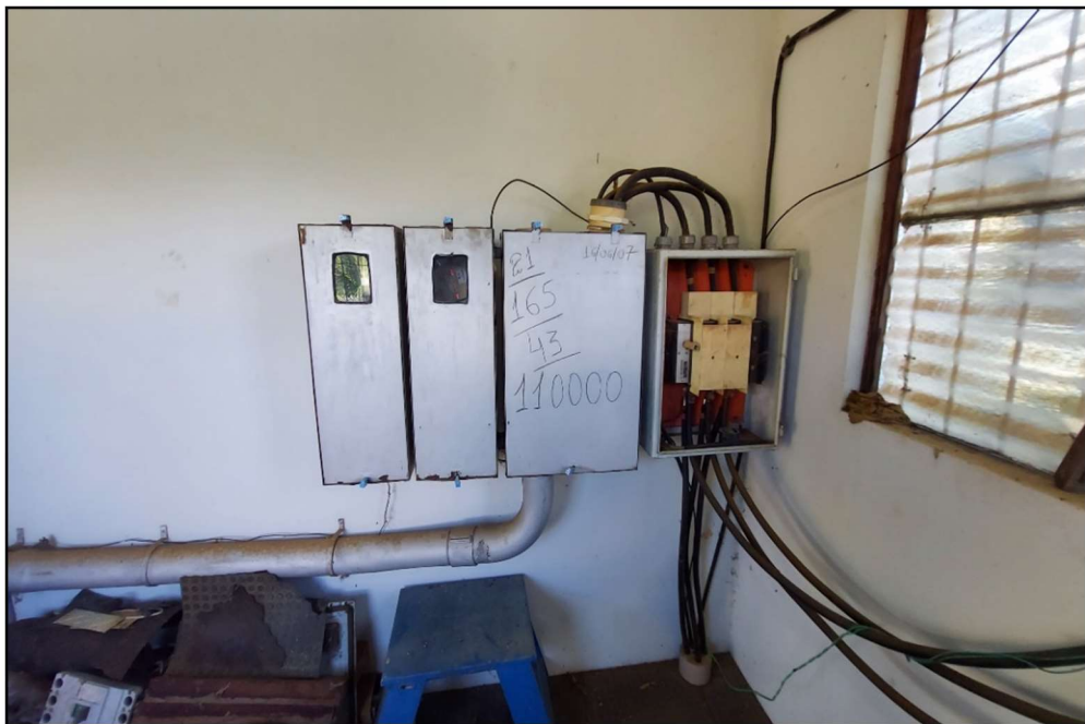
Figura 30 – Quadros Elétricos – Rota de Cabos Inadequada
