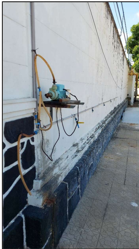
Figura 63 – Bomba Dosadora de Polímero Auxiliar
