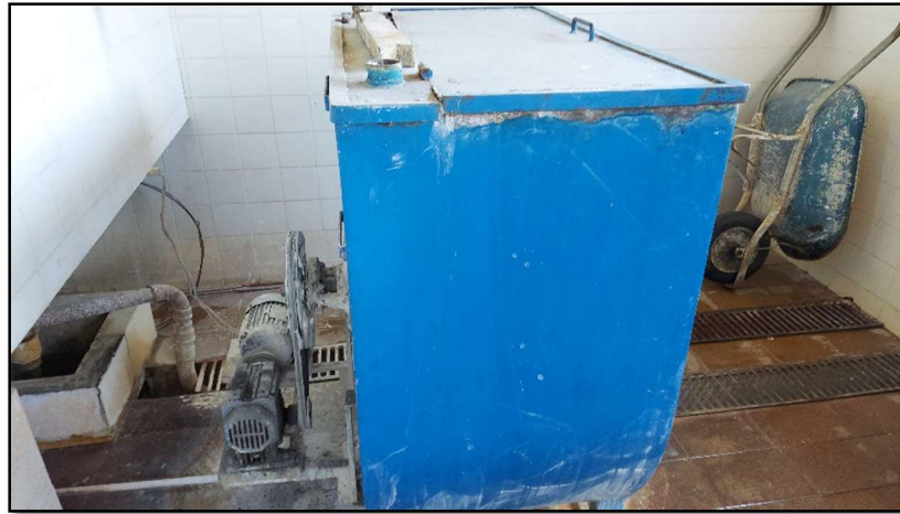
Figura 56– Detalhe do Dosador de Leite de Cal de Canecas
