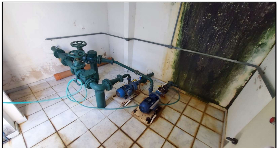
Figura 79 – Elevatória de Água Tratada – Barrilete
