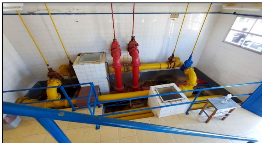
Figura 46 – Barrilete de Manobras dos Filtros Antigos
