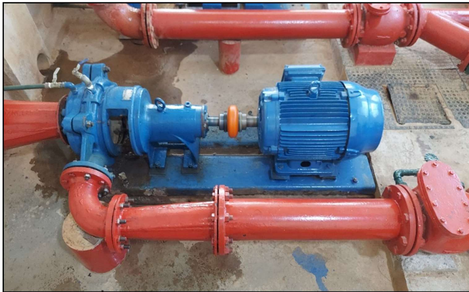
Figura 21 – Detalhe do Conjunto de 40 cv
