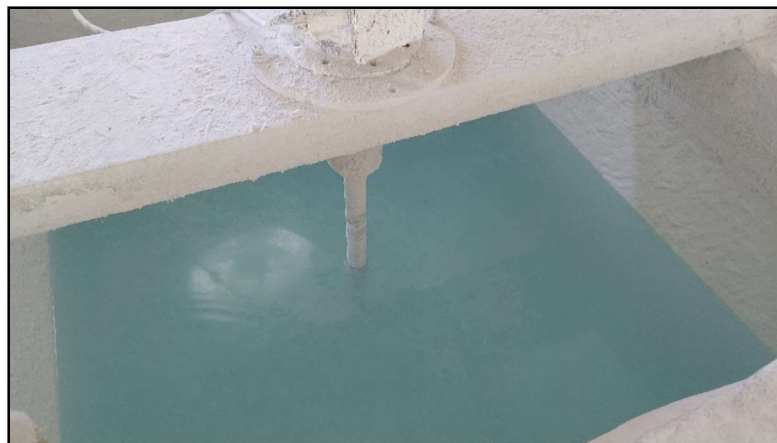
Figura 59 – Vista do Tanque de Preparo de Cal
