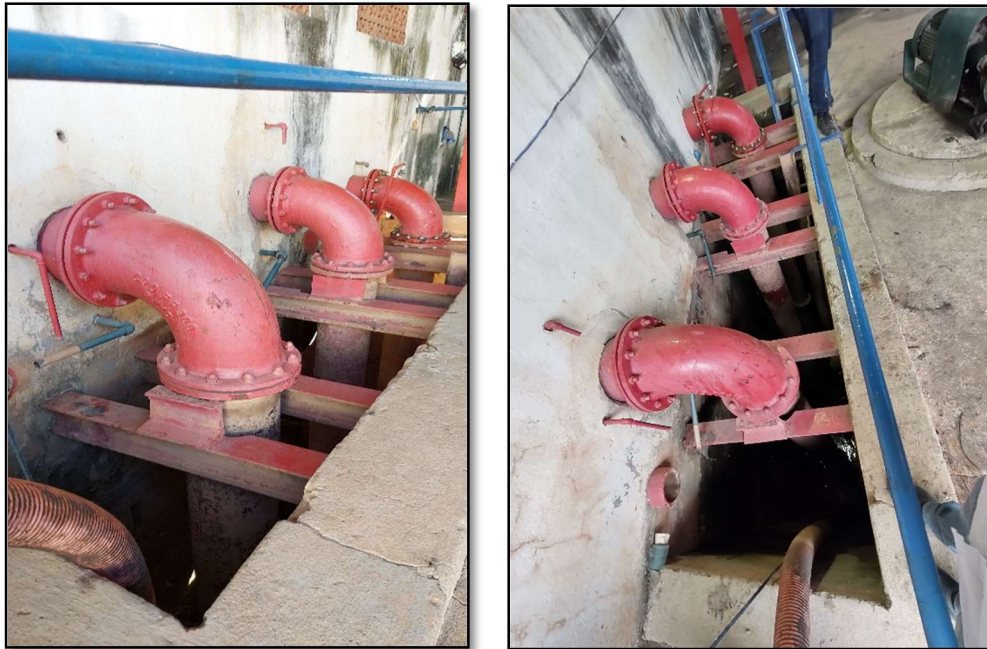
Figura 16 – Poço de Sucção da Elevatória
