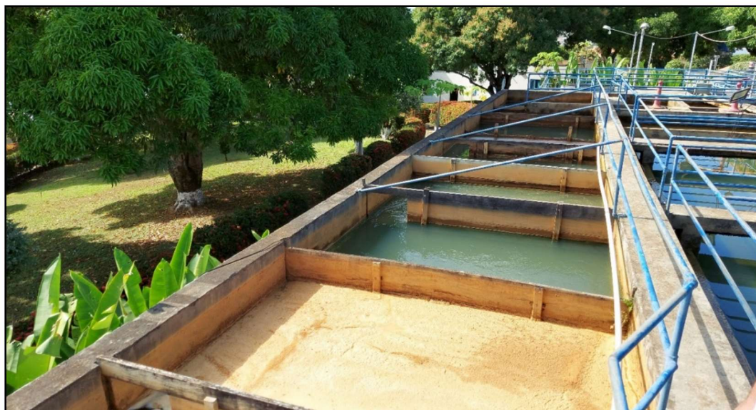
Figura 37 – Flocculador Hidráulico – Vista Frontal
