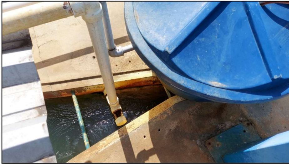
Figura 35 – Ponto de Dosagem de Sulfato de Alumínio
