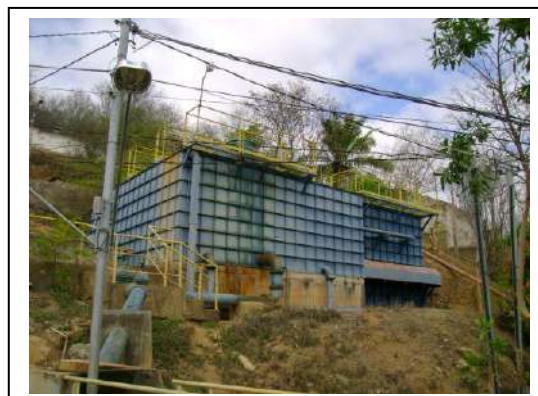
Foto 2.2 – Vista lateral da ETA pré fabricada em chapa de aço, marca Sanevix, vazão de 50 l/s. Não opera, entra somente em funcionamento quando necessário.
