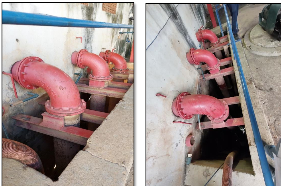
Figura 16 – Poço de Sucção da Elevatória
