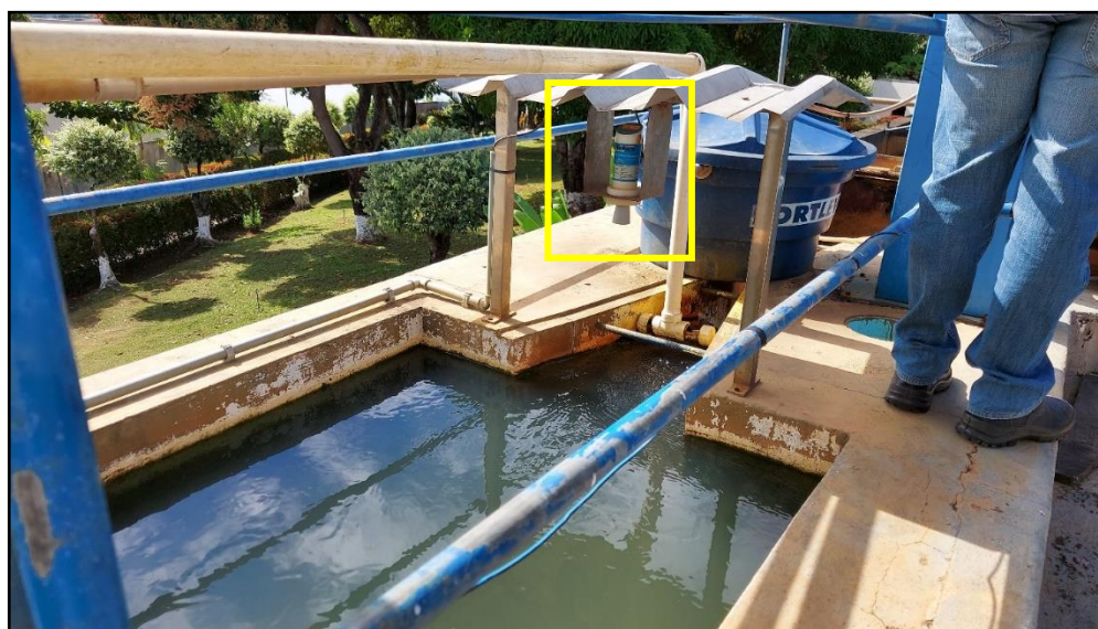
Figura 34 – Medidor Parshall com Destaque para o Medidor Ultrassônico
