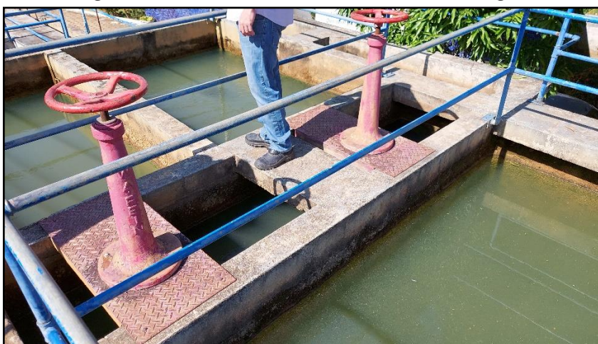
Figura 41 – Detalhe dos Registros de Entrada dos Decantadores e da Antecâmara
