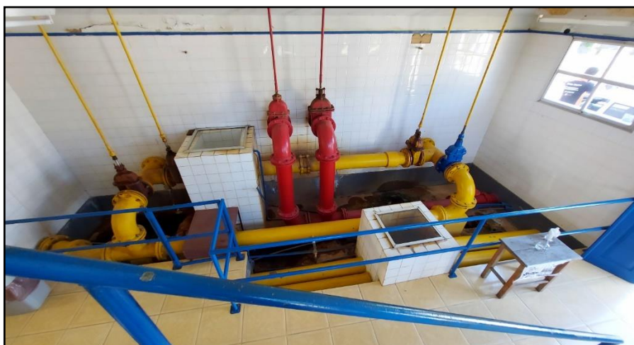
Figura 46 – Barrilete de Manobras dos Filtros Antigos
