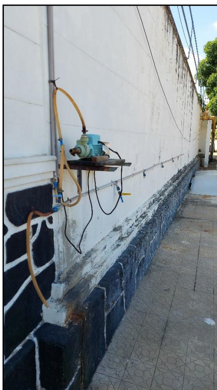
Figura 63 – Bomba Dosadora de Polímero Auxiliar
