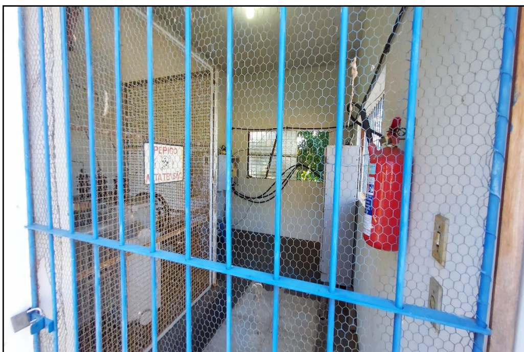
Figura 28 – Vista da Entrada da Subestação Abrigada
