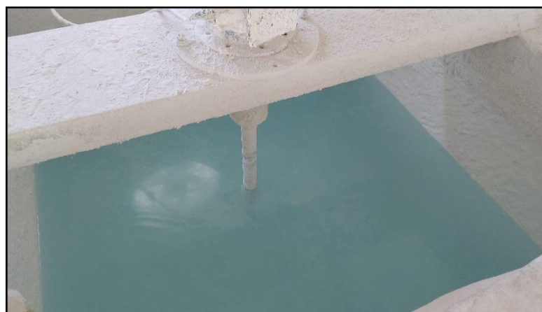
Figura 59 – Vista do Tanque de Preparo de Cal
