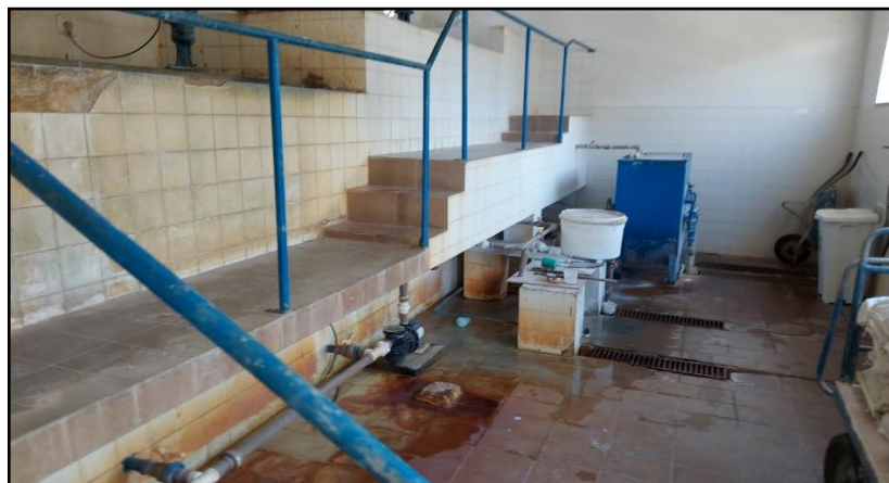
Figura 55 – Vista do Nível Inferior da Sala de Preparo
