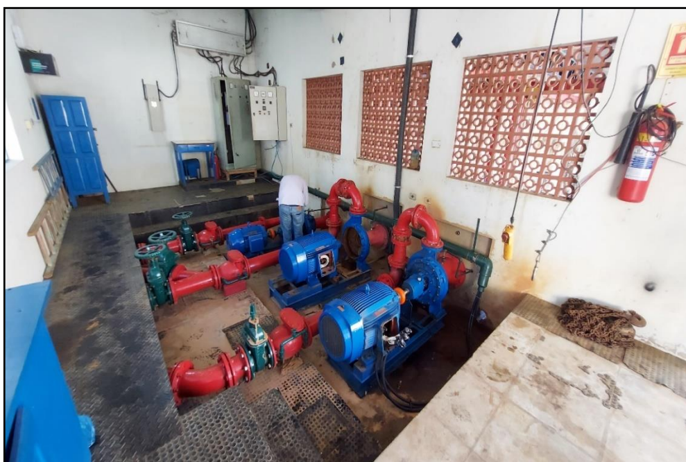
Figura 17 – Vista Geral da Casa de Bombas
