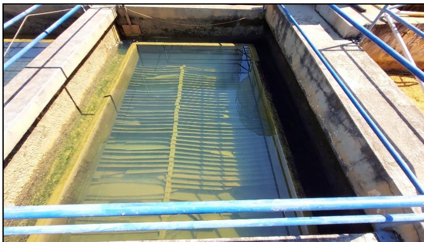
Figura 43 – Detalhe do Estado de Conservação das Placas Paralelas
