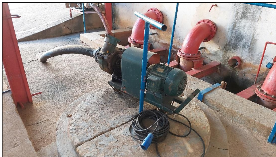
Figura 14 – Poço de Manobra da Captação Mais Profunda
