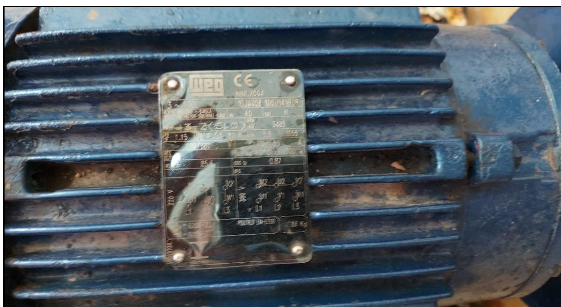
Figura 80 – Placa do Motor Elétrico de 5 cv
