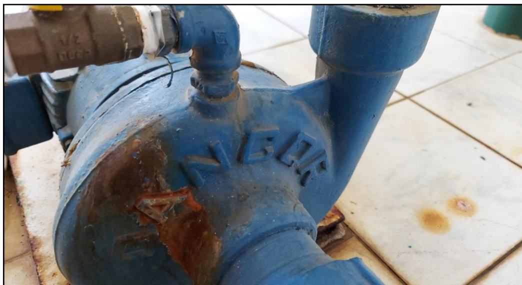
Figura 81 – Detalhe do Conjunto Motobomba
