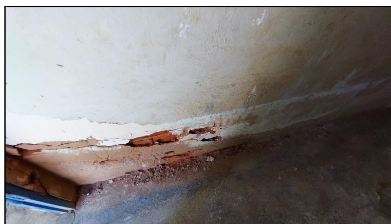
Figura 67 – Almoxarifado – Trincas e Infiltrações
