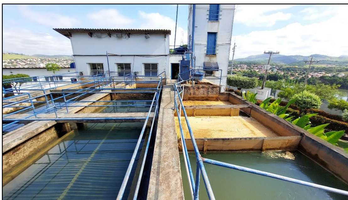
Figura 38 – Flocculador Hidráulico – Vista Posterior
