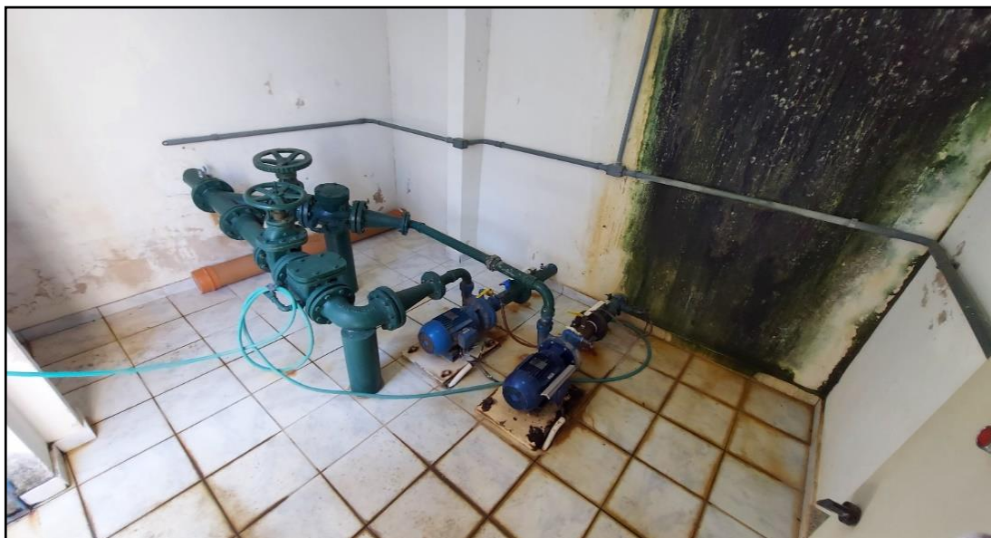
Figura 79 – Elevatória de Água Tratada – Barrilete
