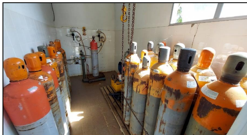
Figura 64 – Cômodo do Sistema de Gás Cloro
