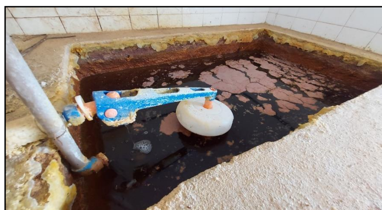
Figura 61 – Detalhe do Tanque de Nível Constante do Sulfato
