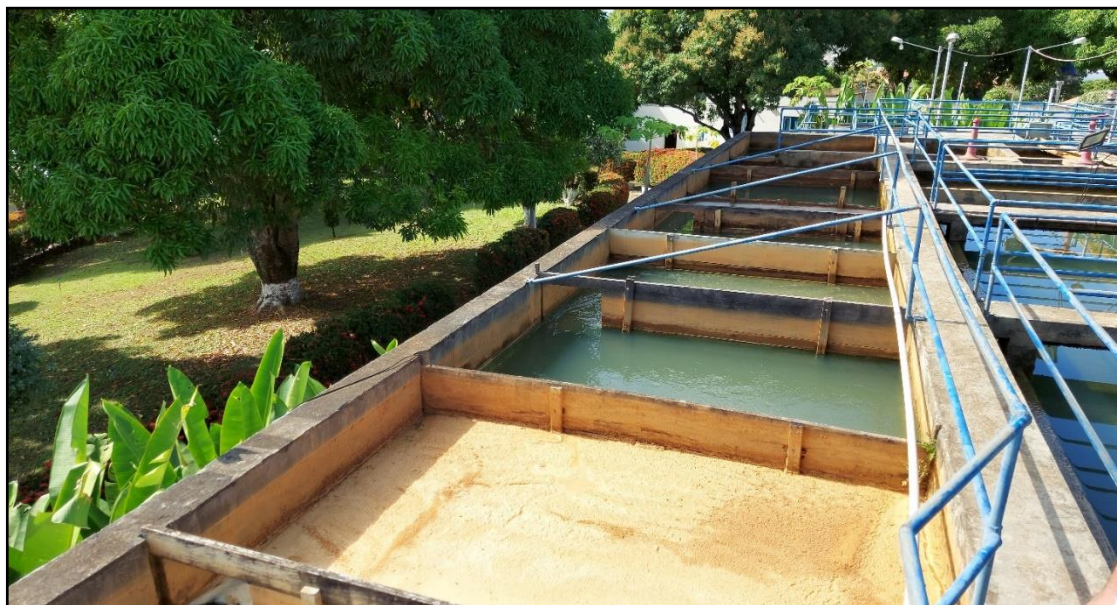
Figura 37 – Flocculador Hidráulico – Vista Frontal
