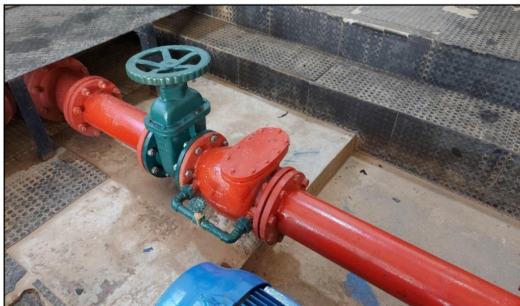
Figura 22 – Detalhe das Válvulas no Trecho Individual de Recalque
