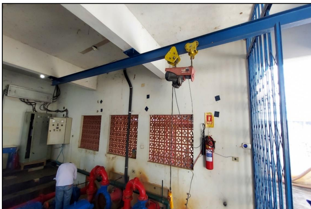
Figura 18 – Casa de bombas – Monovia
