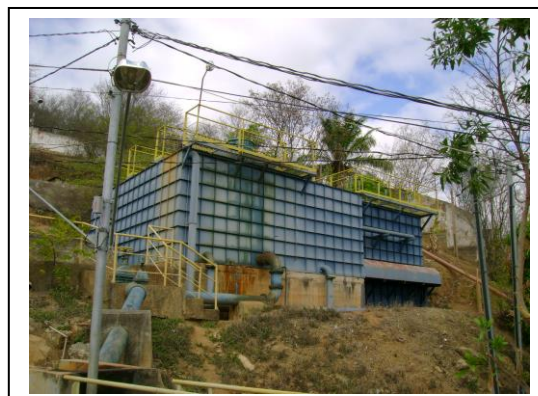
Foto 2.1.6 – Vista lateral da ETA pré fabricada em chapa de aço, marca Sanevix, vazão de 50 l/s. Não opera, entra somente em funcionamento quando necessário.
