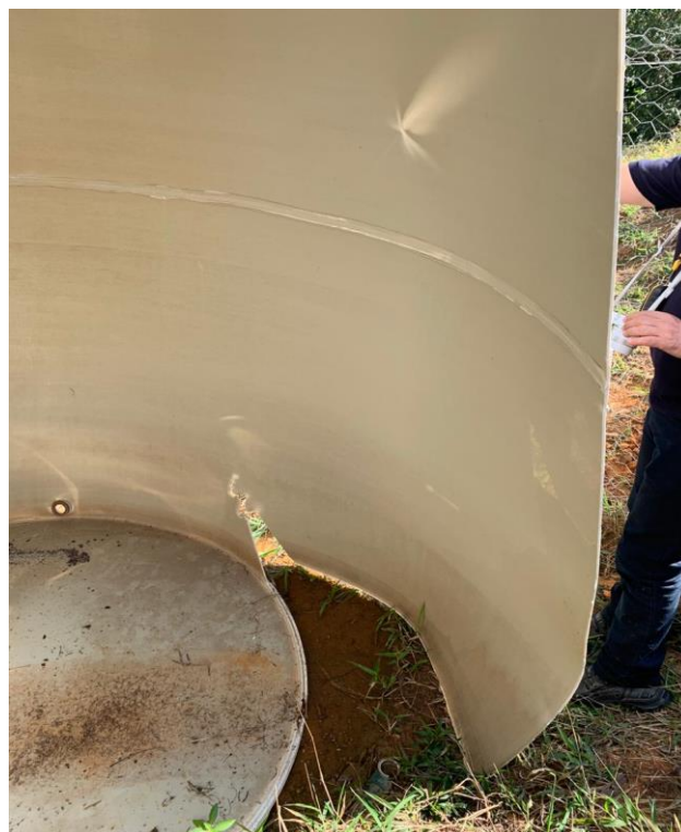
Figura 47 – reservatórios de PEAD rompidos
