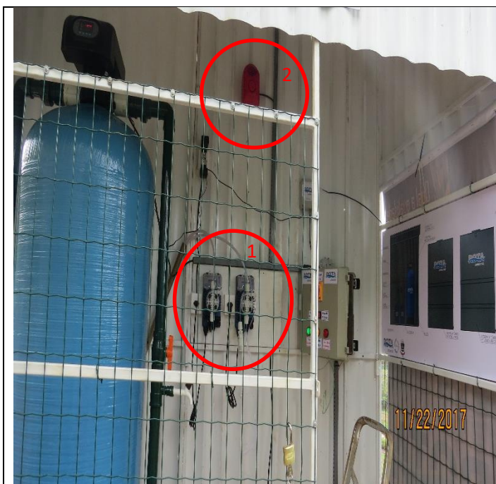
Figura 26 - Instalação das bombas dosadoras (1) e do alarme (2) de aviso de fim de produto químico.
