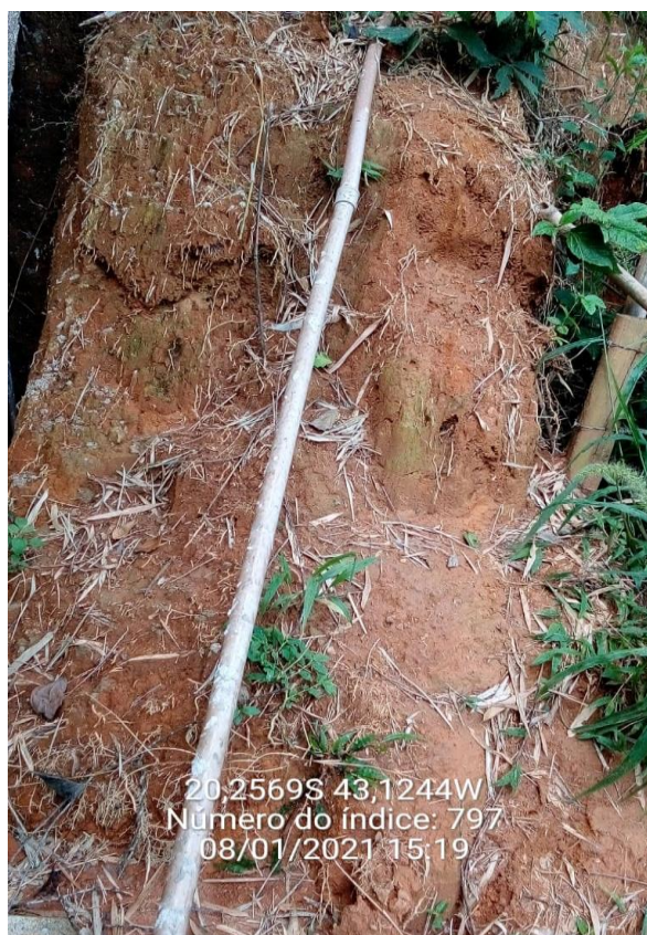
Figura 53 - Tubulação anteriormente rompida e ligação Poço 02 – Posto de saúde, após construção das casas em cima da tubulação e cabeamento elétrico.
