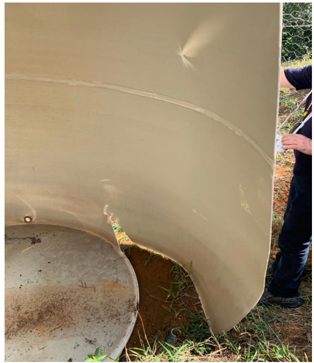
Figura 49– reservatórios de PEAD rompidos
