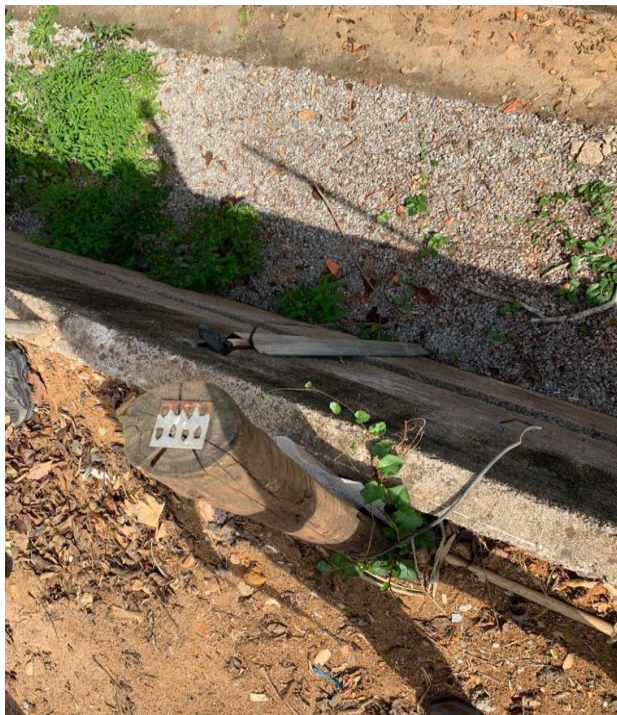
Figura 44 – Rede elétrica rompida
