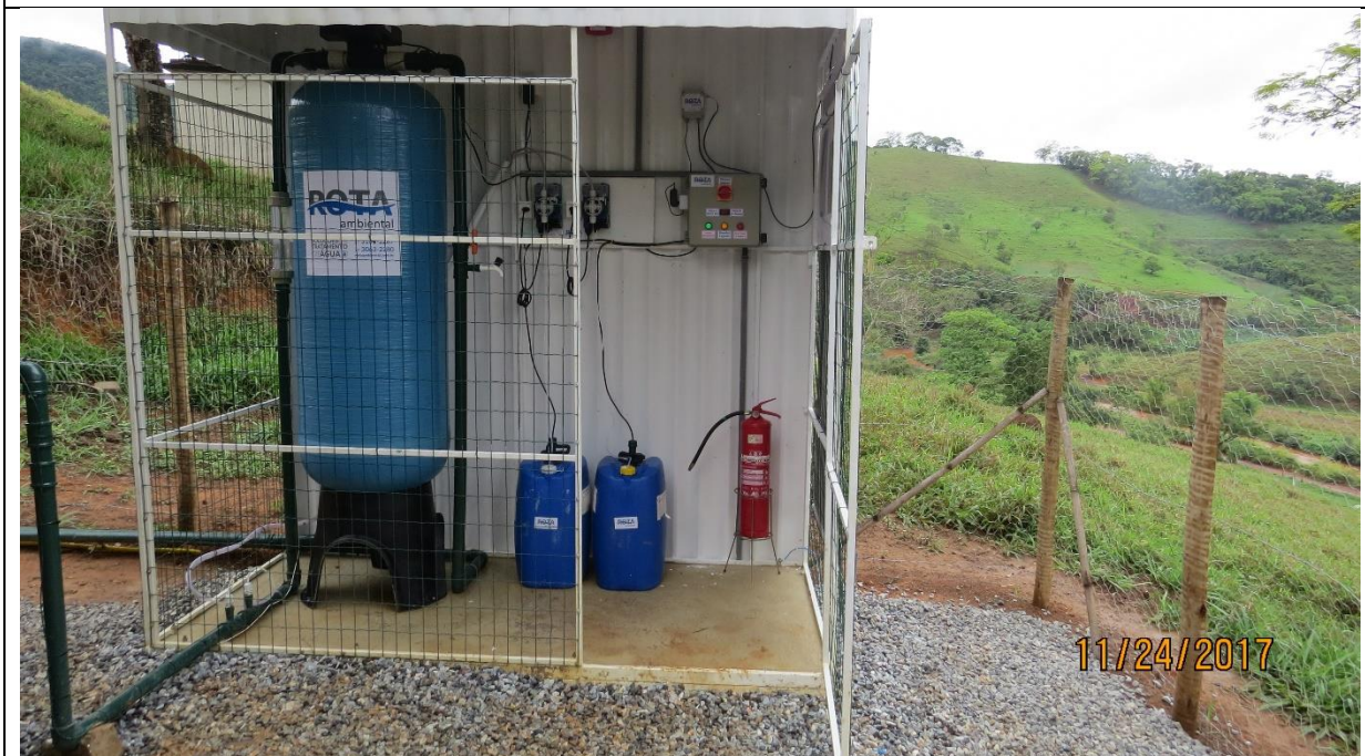
Figura 35 - Sistema de tratamento de água completo: Filtro, pintura da tubulação, bombonas com produtos químicos, bombas dosadoras, quadro de comando etc.
