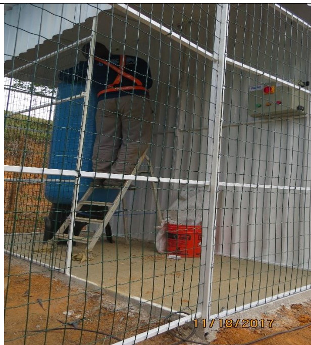
Figura 17 - Colocação do "blend" utilizado como meio filtrante.
