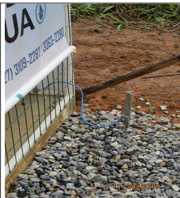
Figura 31 - Sistema de aterramento.
