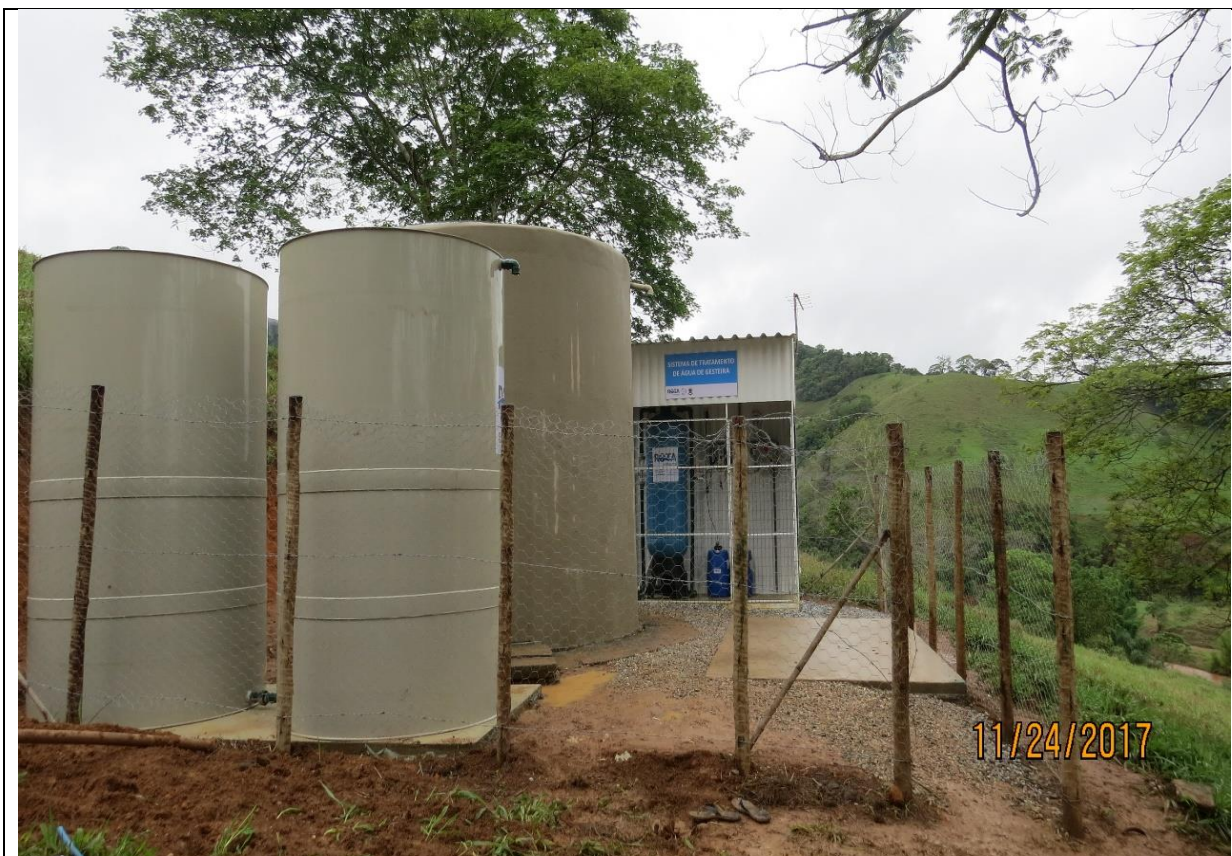
Figura 34 - Vista do sistema de tratamento de água e reservação do Distrito de Gesteira.
