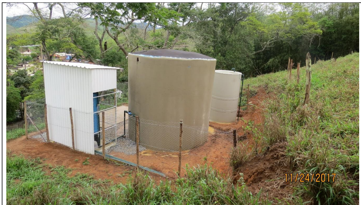
Figura 39 - Vista superior do sistema de tratamento, onde evidencia-se a pintura externa realizada no reservatório antigo.
