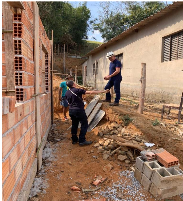
Figura 45 – Tubulação rompida devido a passagem das máquinas para construção da casa.
