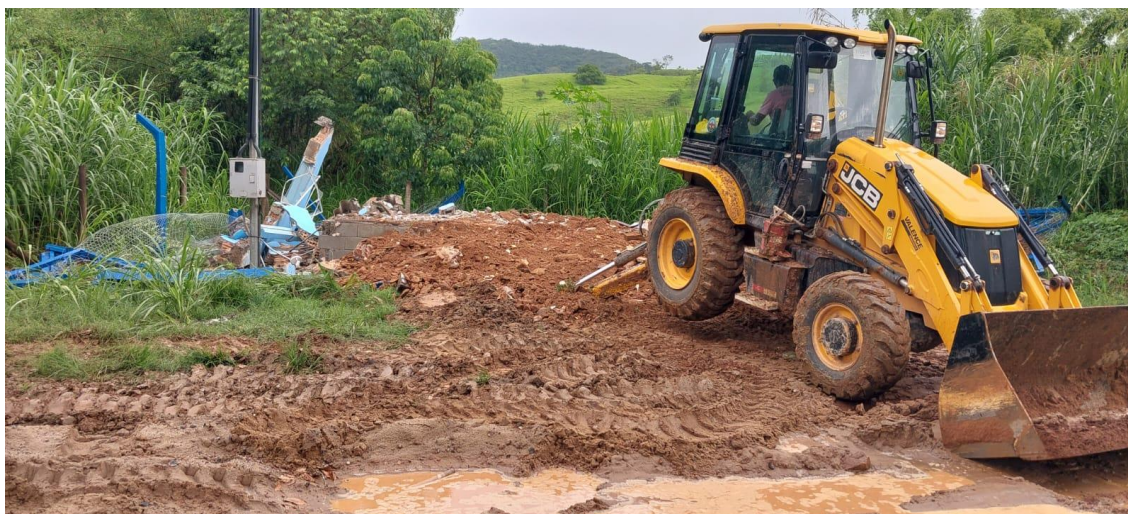
Figuras 76 a 81 – imagens do dia 21/12/23 no momento da destruição da obra
