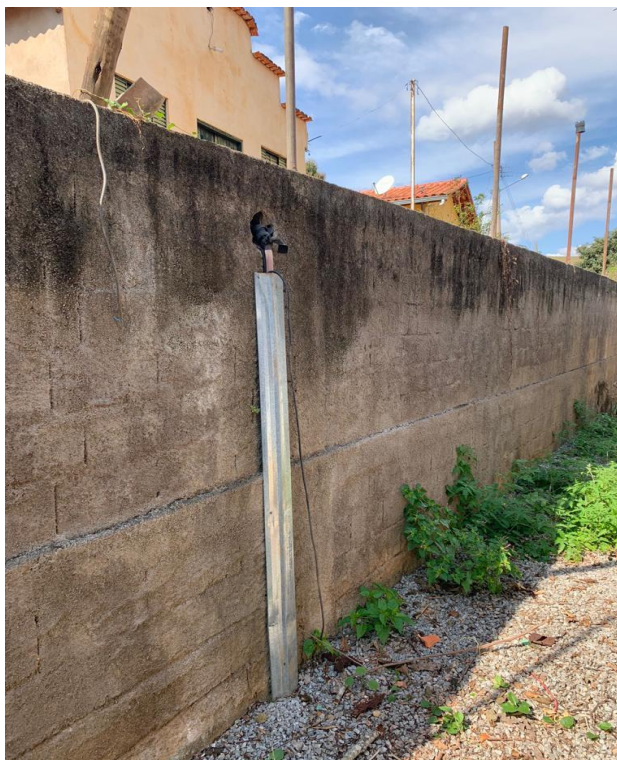
Figura 42 – Muro de contenção do Posto de Saúde após construção da casa, já em risco de desabamento.
