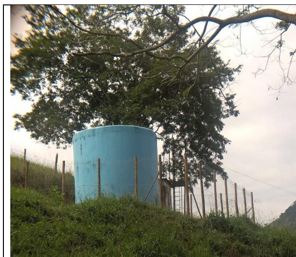
Figura 1 - Reservatório de cerca de 15m 3 (água do poço beira rio)
