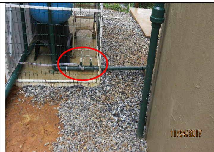
Figura 37 - Detalhe dos pontos de dosagem de produtos químicos
