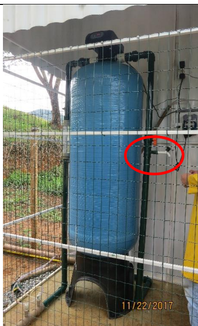
Figura 24 - Filtro com a cabeça eletrônica instalada, com as tubulações de entrada "água bruta" e saída "água tratada" (ver detalhe), começando a receber a pintura definitiva.
