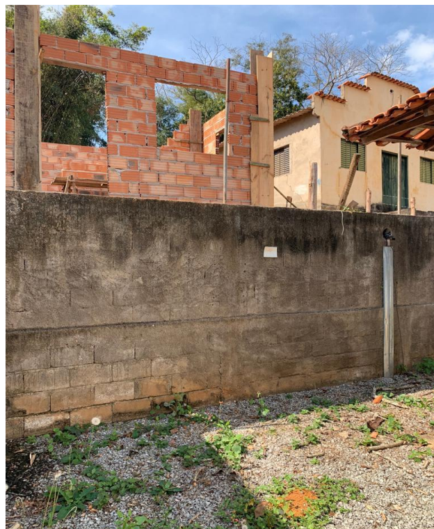
Figura 43 - Casa construída no local de acesso ao SAA, responsável pelo rompimento dos dutos e cabeamento elétrico do SAA.
