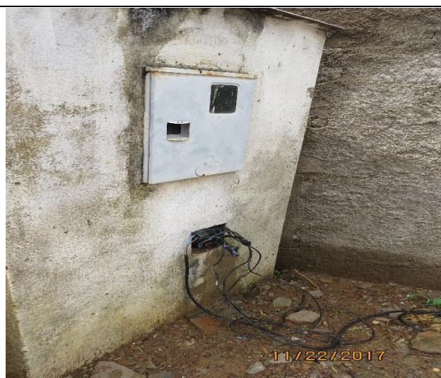
Figura 28 - Situação do padrão instalado no posto de saúde, anterior à instalação da parte de telemetria dos poços
