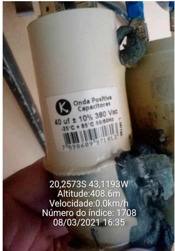
Figura 55 - Capacitores Poço 01 – Beira Rio, queimado.
