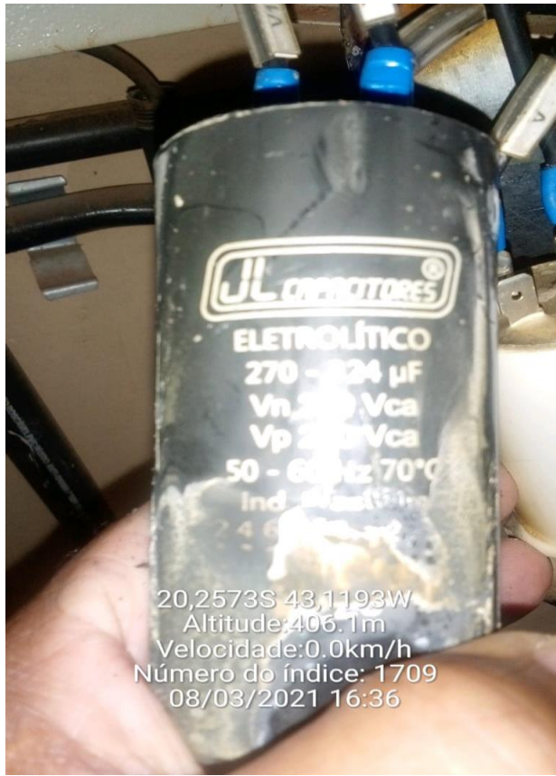
Figura 54 - Capacitores Poço 01 – Beira rio, queimado.
