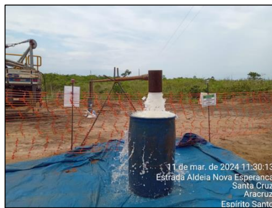
Foto 6 – Teste de Vazão e Coleta de água para realizar o Teste de Qualidade do Poço de Nova Esperança
