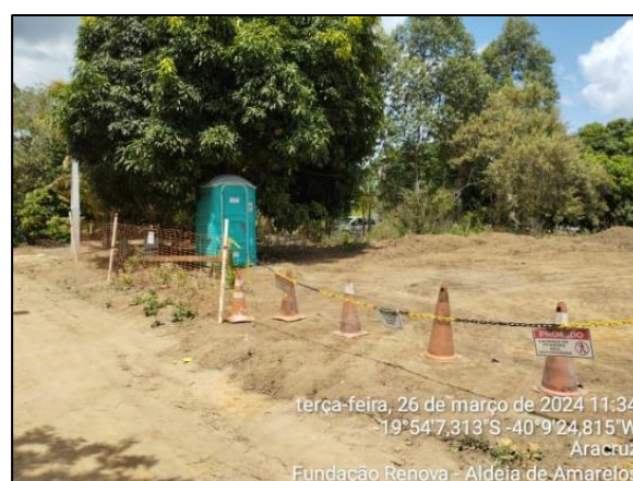
Foto 8 – Praça de Trabalho para a Perfuração do Poço Instalada na Aldeia de Amarelos
