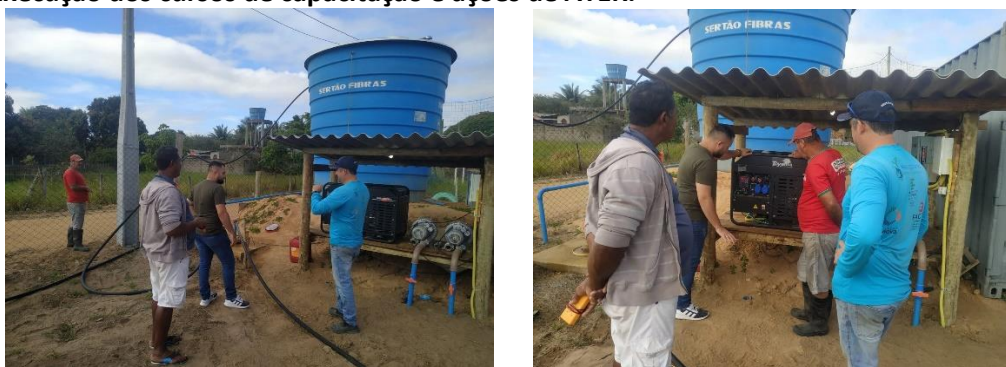
Figura 108. Visita técnica da empresa responsável pela instalação dos geradores para a realização de uma manutenção de rotina nos equipamentos e na rede elétrica. A revisão foi realizada com a participação da equipe dos atingidos beneficiários.
