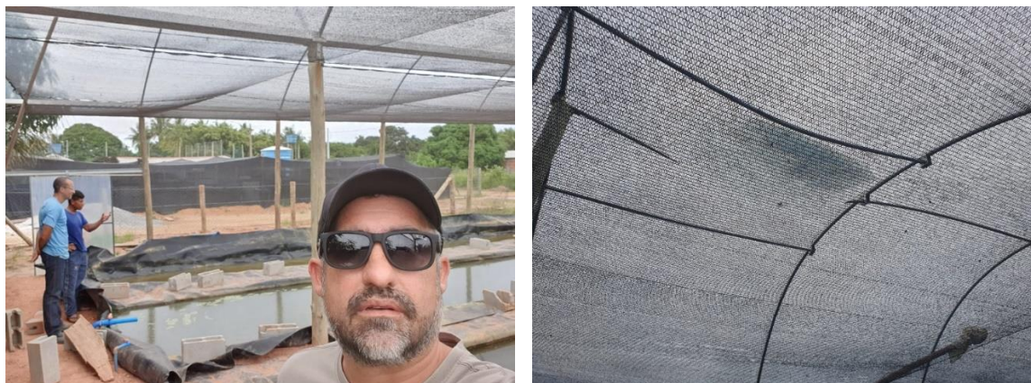
Figura 167. Visita técnica destinada a verificar os danos causados a estufa pela chuva em Areal.
