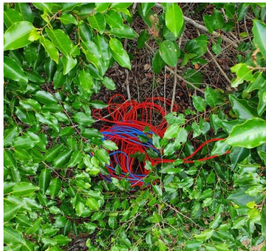
Figura 116. Registro do material roubado das instalações elétricas provisórias utilizadas para a montagem da estufa em Regência.
