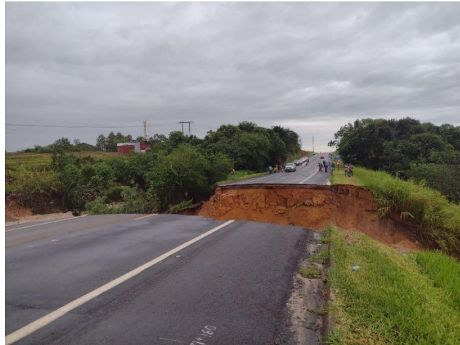
Figura 152. Rompimento total da BR 101 na chegada à Linhares por São Mateus.
