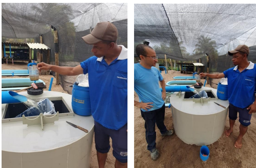
Figura 169. Realização de manutenção dos filtros de Povoação.
