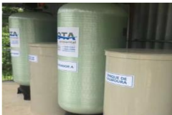
Instalação do Filtro de Carvão e abrandadores e tanques de salmoura - São Tomé do Rio Doce – fevereiro/2018 (Crédito: Divulgação Fundação Renova)
