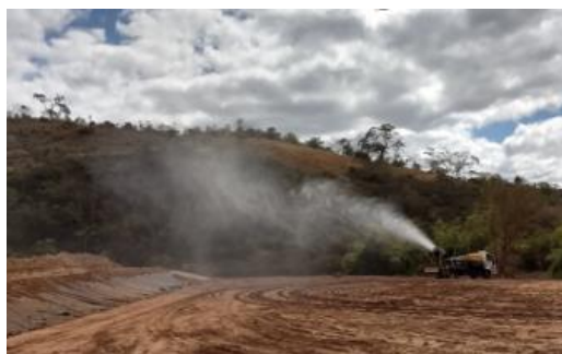
Canhão de névoa instalado no parque de exposições em Barra Longa (Crédito: Divulgação Fundação Renova)
