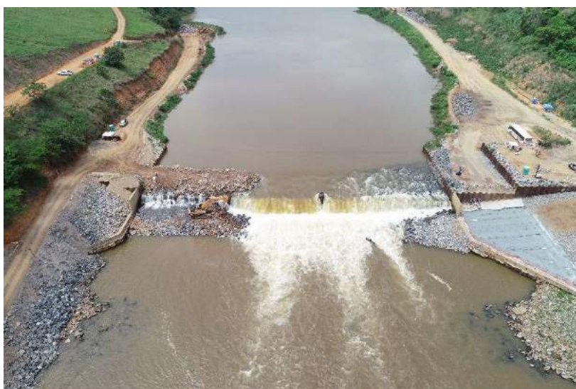
Foto relacionada à: Barramento C – novembro/2020.
